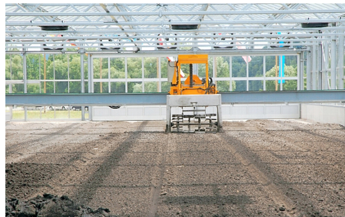
Mit Sonnenkraft wird in der Rödentaler Abwasserreinigungsanlage der Klärschlamm getrocknet.
